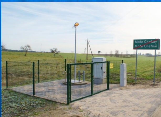
Przepompownia ścieków w Małych Chełmach
